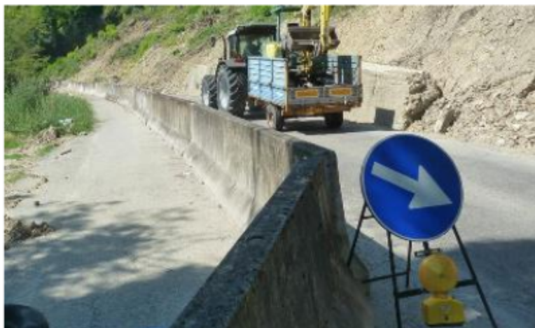
Il punto della Bidentina, all'altezza di Pianetto (Galeata), in cui la strada è franata
